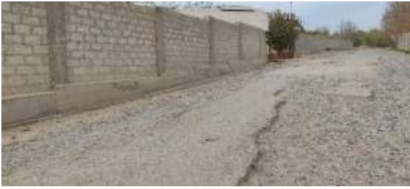
Роҳи сангфарш вайроншуда
