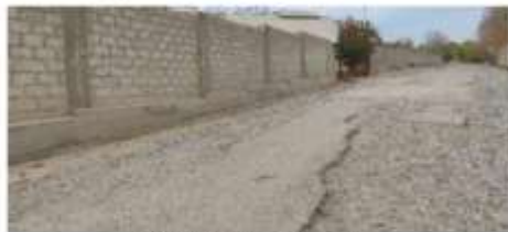
Роҳи сангфари ҷайроншуда
