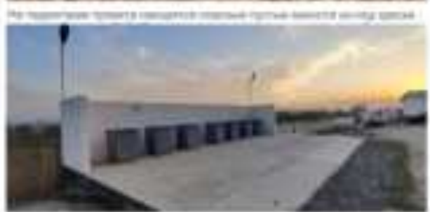
На территории проекта сооружен стальной корпус высотой между 0,8м и 1,2м
