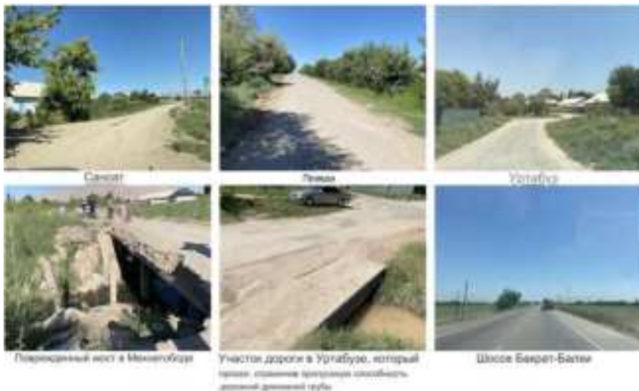
Фото V 4: Состояние дорог (29 июня 2022 г.)
