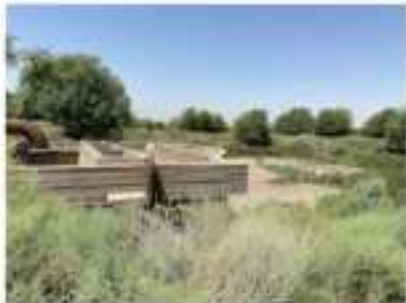
Коммунальное очистное сооружение канализации, построенное в советское время
